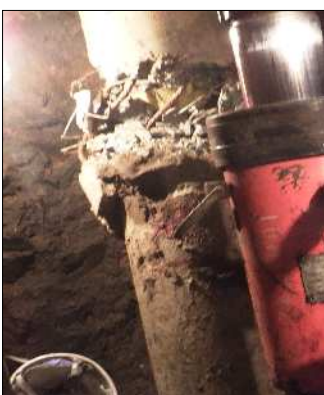
写真-1 既存杭損傷状況
