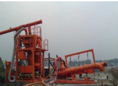
写真-8 管路処理装置(管路システム)
