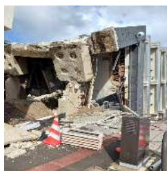
写真-10 ビル転倒現場 基礎梁が折れ、フーチングの裏には杭跡
