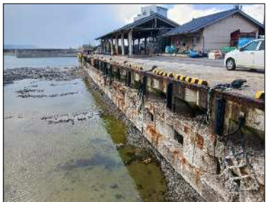
写真-8 4m近く隆起した鹿磯漁港
